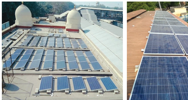
कानपुर रेलवे स्टेशन पर सोलर पावर पैनल विद्याचल रेलवे स्टेशन पर सोलर पावर पैनल
